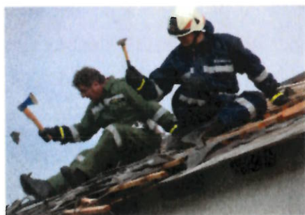
Stundenlang arbeiteten unsere Feuerwehrmitglieder an den Schäden.
