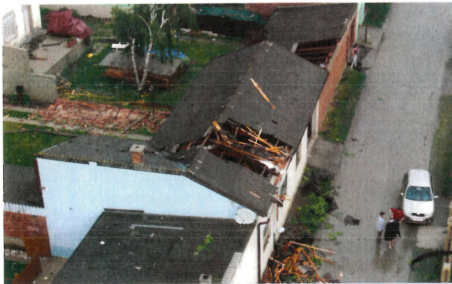
Häuser, Mäuer, Fassaden und Autos wurden vom Tornado in Mitleidenschaft gezogen. Glücklicherweise kamen keine Personen zu Schaden.
